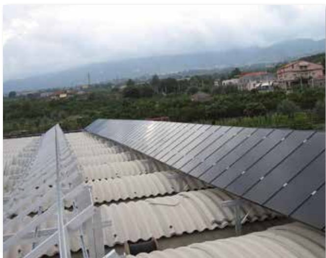
Installazione su tetto e cupolotti e triangolo FVT1511.
