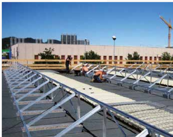
Tetto piano industriale con guaina. Applicazione con vasche zavorra FVT1455 e triangoli a 30° FVT1511.
