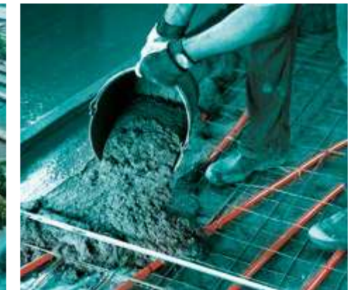
RISCALDAMENTO A PAVIMENTO
